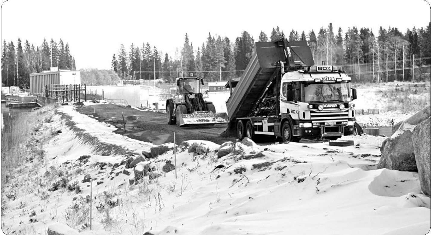
På bilden ovan ser vi det pågående arbetet vid Bodens kraftverk. Nedan en vacker vintervy från bostadsrättsföreningen Sandidan.
