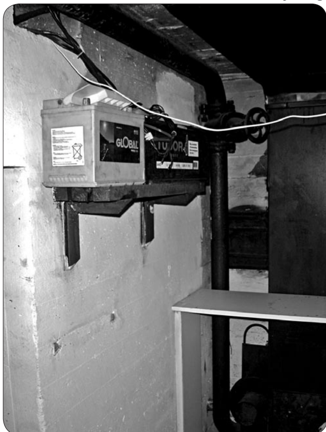
Batterier som förser rummet med 12 Volts belysning.
